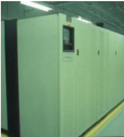
Módulo de corriente regulada ininterrumpida
