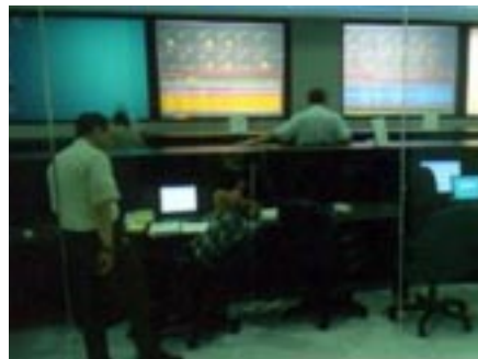
Centro de control
