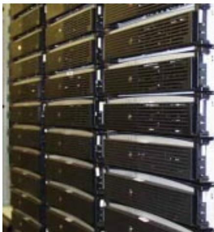
Gabinete de servidores
